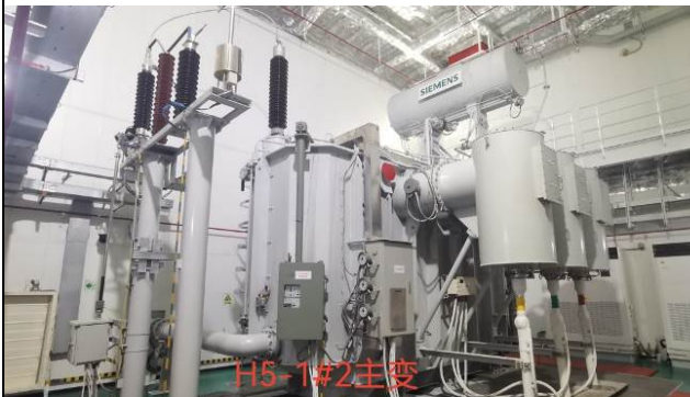
H5-1#海上升压站主变压器
