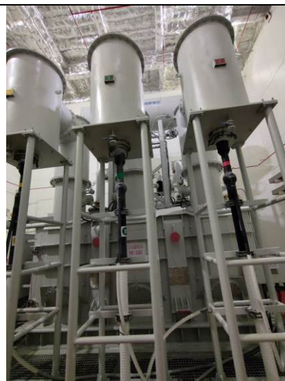
H5-2#海上升压站高压电抗器
