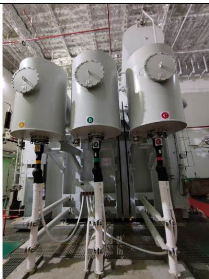
H5-2#海上升压站主变压器
