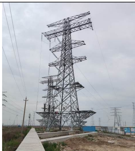
架空线及铁塔
