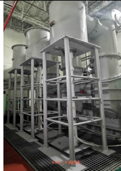
H5-1#海上升压站高压电抗器
